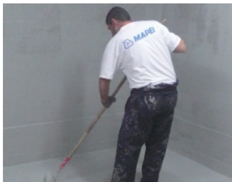
Mapelastic Foundation appliqué au rouleau pour imperméabiliser le sol de l'eau en contre-pression
